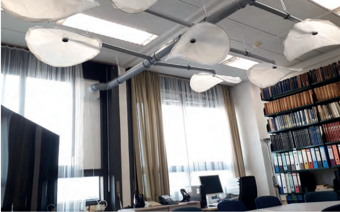
Abb. 2: Installiertes Entlüftungssystem mit Absaughauben.
